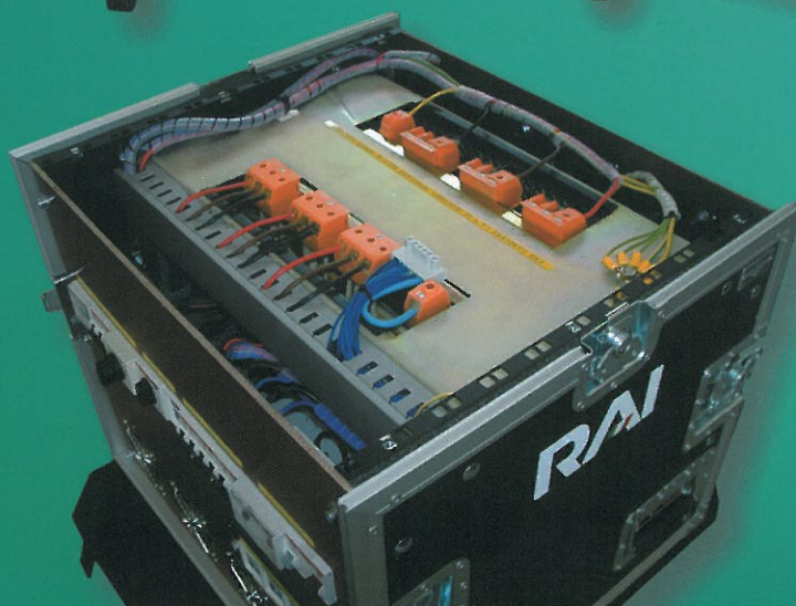
Particolare del cablaggio interno
